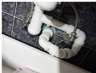
Rørgjennomføring i vegg under servant
