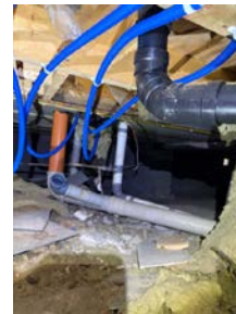
Mangler isolasjon og stubbloftsplater
