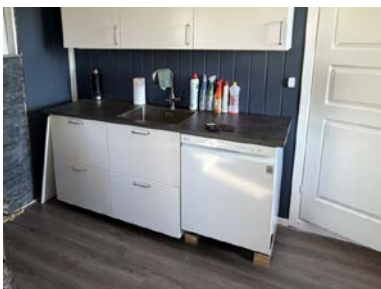
Uferdig, mangler sokler og endeplate.
