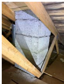
Eldre fuktmerker, misfarget bordtro
