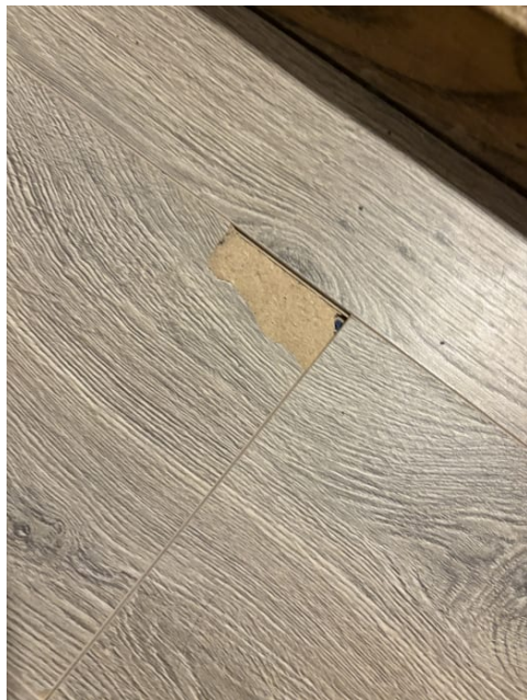
Skader i laminatgulv.
