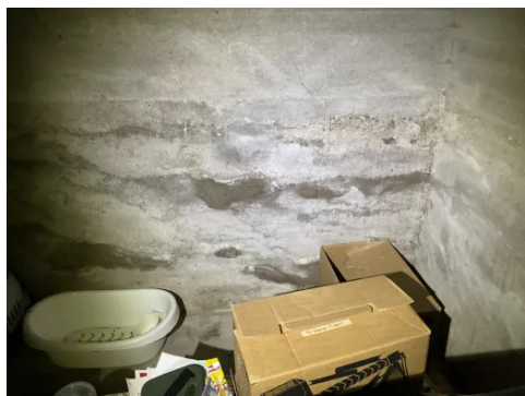
Salt/kalkutslag i kjeller.
