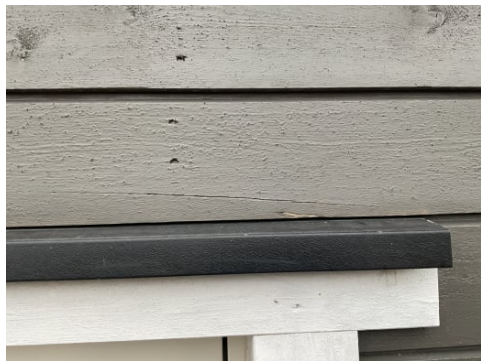
Sprekk i panel.
