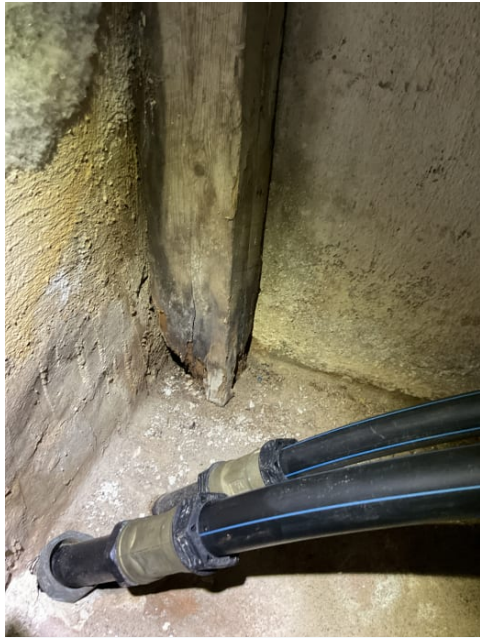
Råteskader i treverk.
