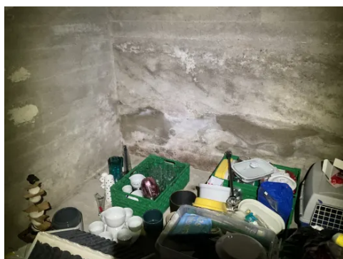
Salt/kalkutslag i kjeller.
