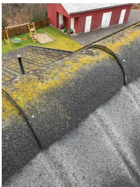
Løs innfesting av takteking.
