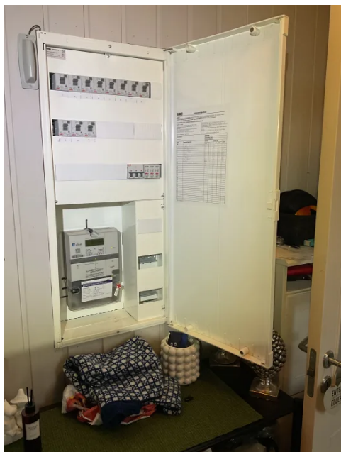
Sikringskap i gang.
