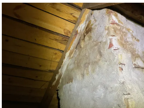
Fuktmerker rundt pipe.
