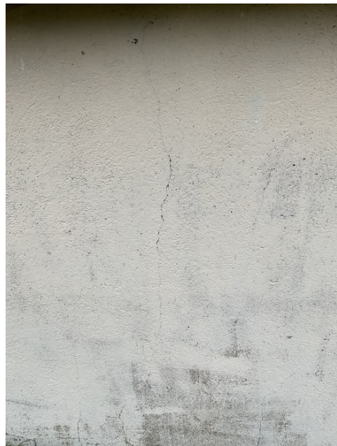
Sprekker i grunnmuren.
