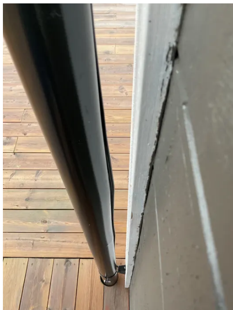
Frostspreng i nedløp.
