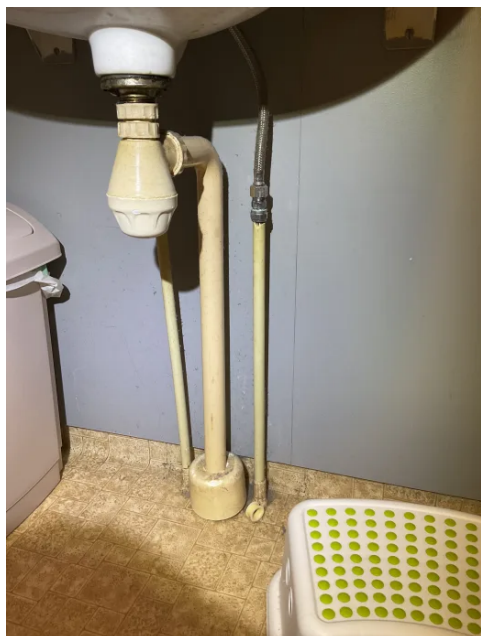
Vannrør på bad.
