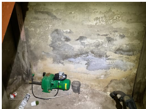
Salt/kalkutslag i kjeller.
