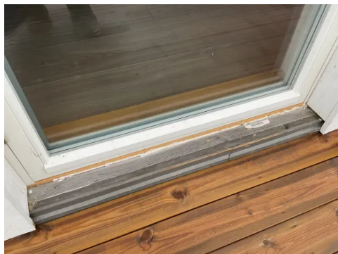
Manglende beslag til terrassedør.
