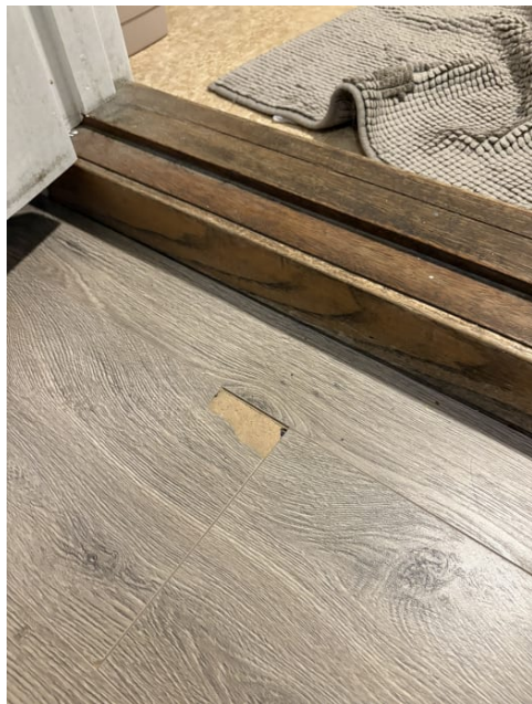
Skader i laminatgulv.
