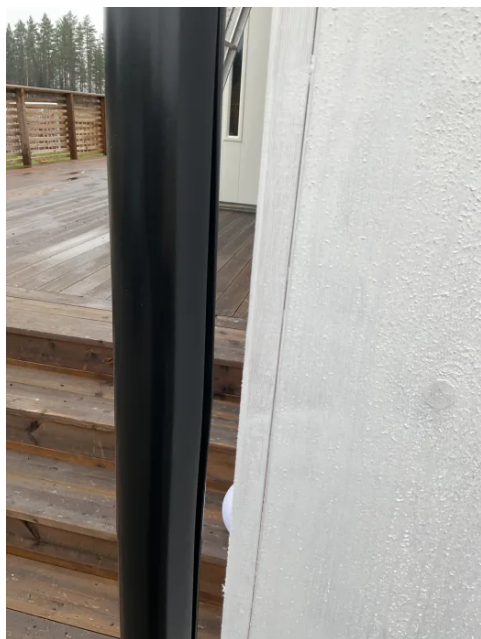
Frostspreng i nedløp.
