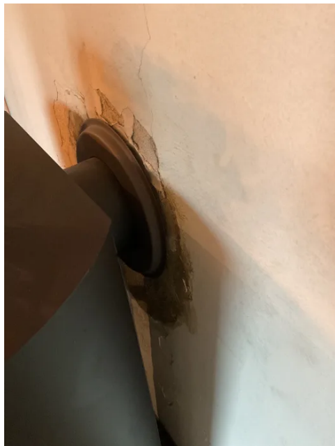
Avskalling i puss/maling rundt røykgjennomføring.
