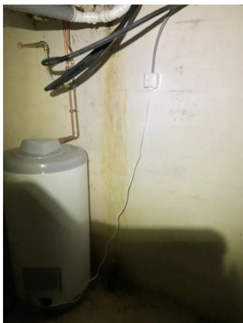
Dårlig innfesting av kabler.
