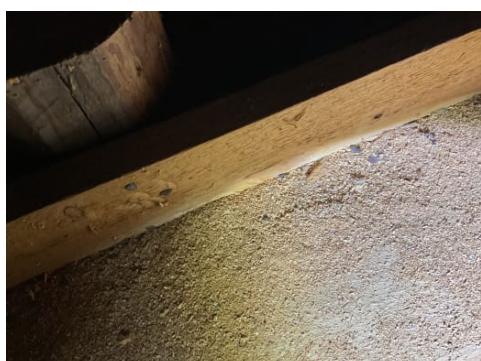
Spor etter skadedyr.
