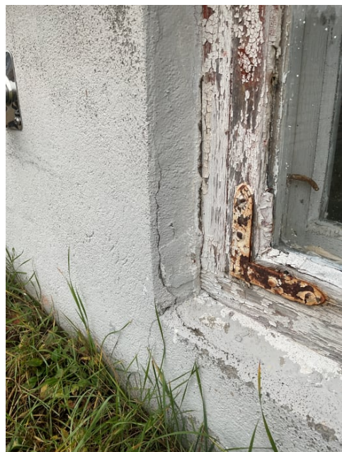
Sprekk i grunnmuren.
