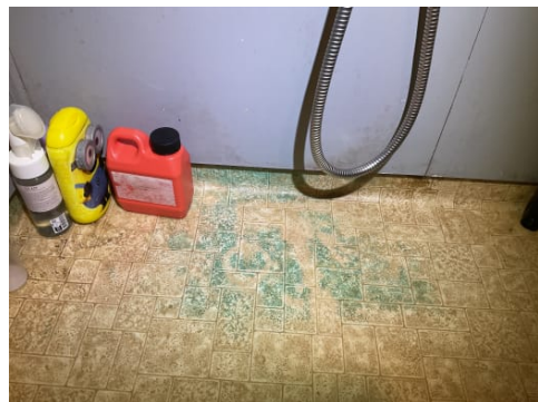
Missfarging på plater og belegg.
