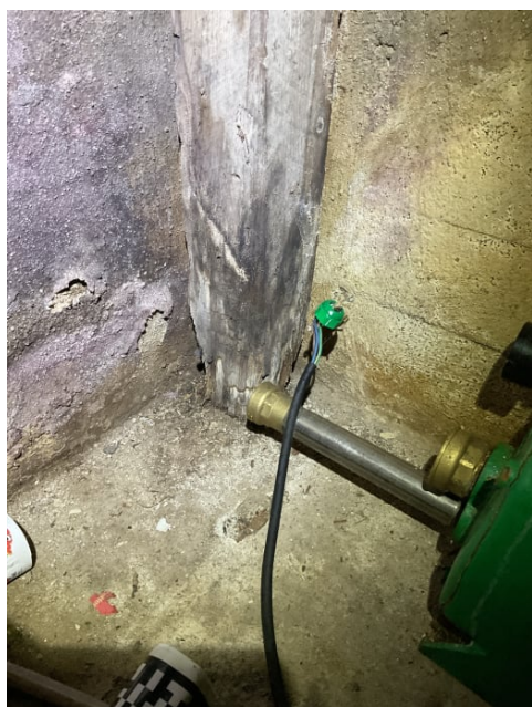
Råteskader i treverk.
