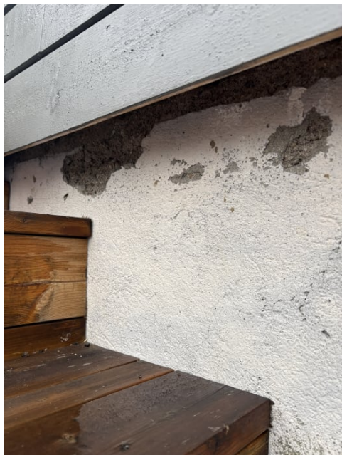
Avskalling på puss.
