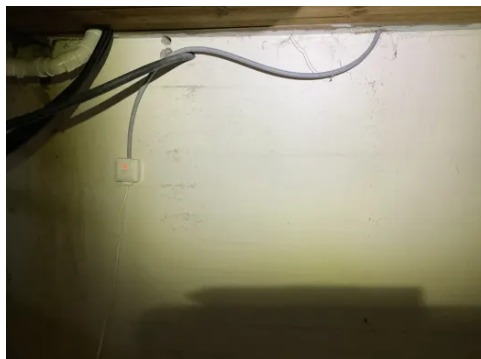
Dårlig innfesting av kabler.
