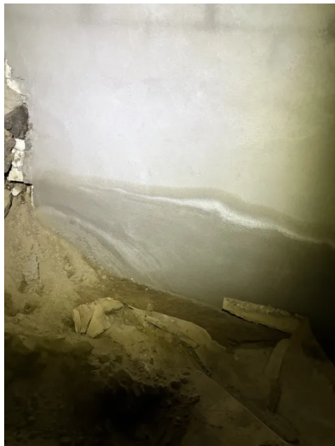
Fuktighet i jordgulv og saltutslag.
