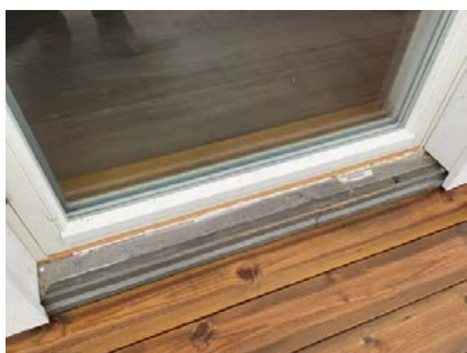
Manglende beslag til terrassedør.
