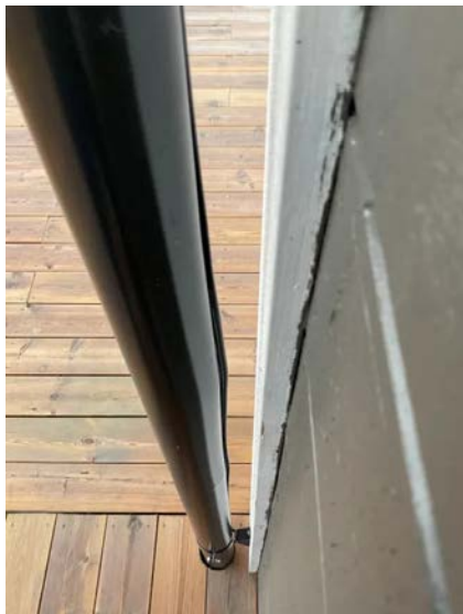
Frostsprengh i nedløp.
