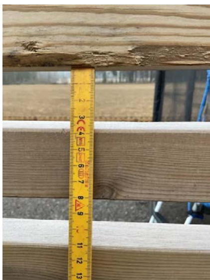
Avstand mellom spiler i rekkverk.
