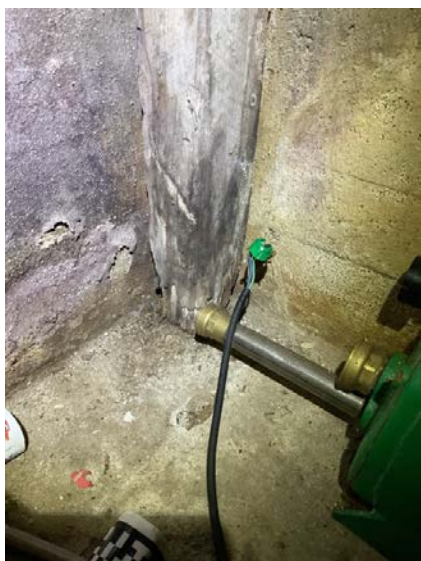
Råteskader i treverk.
