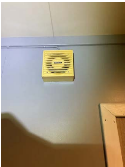
Avtreksvifte på bad .
