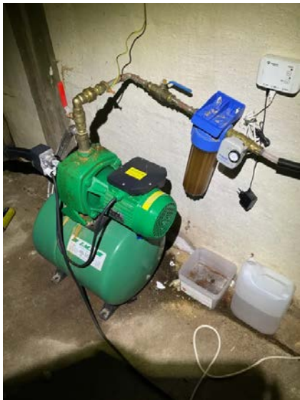
Stoppekran og vannpumpe.
