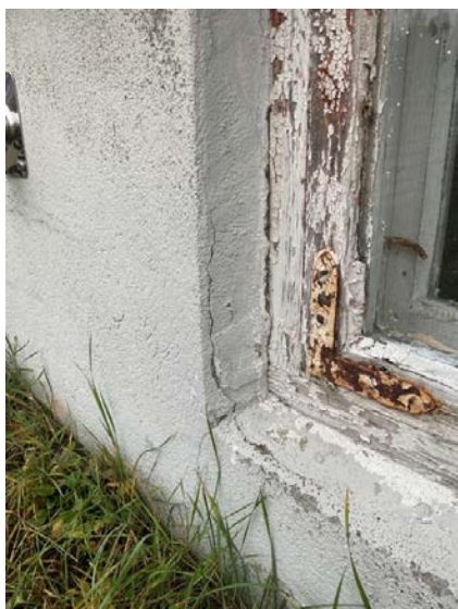
Sprekk i grunnmuren.
