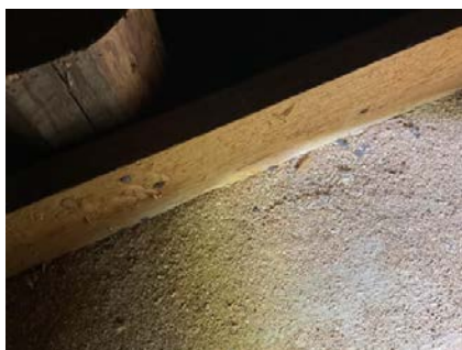
Spor etter skadedyr.
