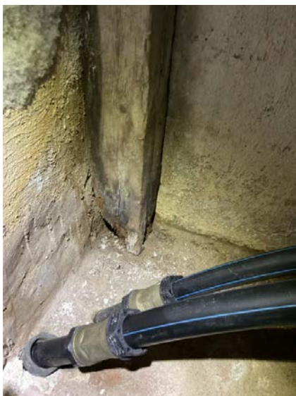
Råteskader i treverk.
