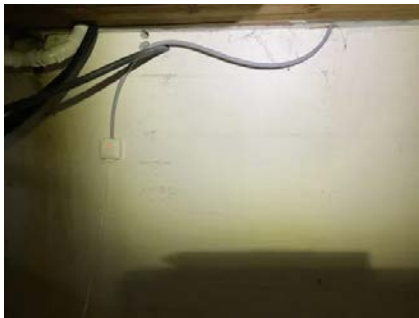
Dårlig innfesting av kabler.
