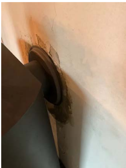
Avskalling i puss/maling rundt røykgjennomføring.
