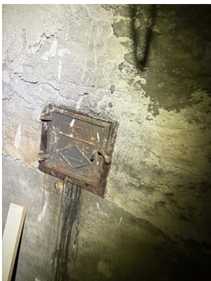
Rennemerke fra sotluke i kjeller.
