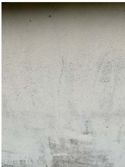
Sprekker i grunnmuren.
