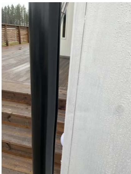
Frostsprengh i nedløp.
