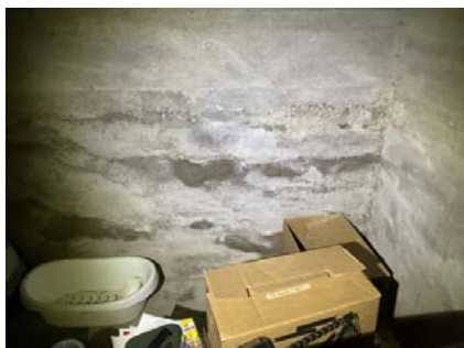
Salt/kalkutslag i kjeller.
