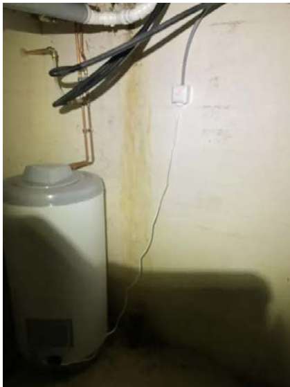
Dårlig innfesting av kabler.
