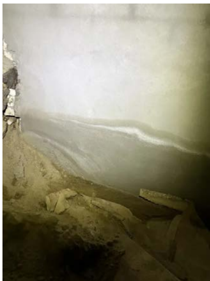
Fuktighet i jordgulv og saltutslag.
