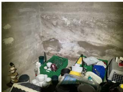
Salt/kalkutslag i kjeller.
