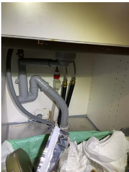
Vannrør på kjøkken.
