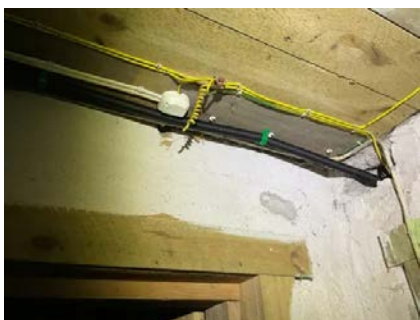
Dårlig innfesting av kabler.
