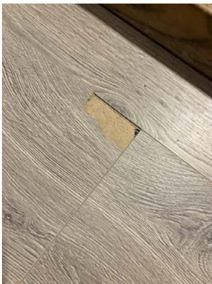
Skader i laminatgulv.
