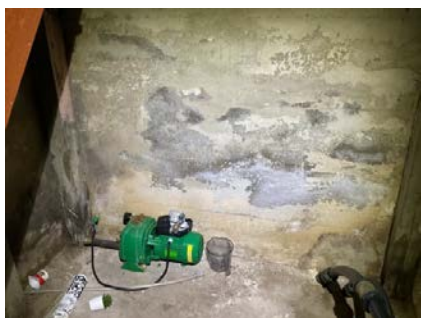
Salt/kalkutslag i kjeller.
