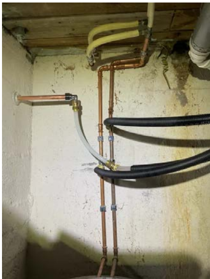
Vannrør i kjeller.
