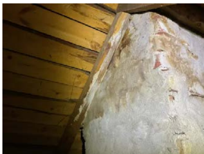
Fuktmerker rundt pipe.
