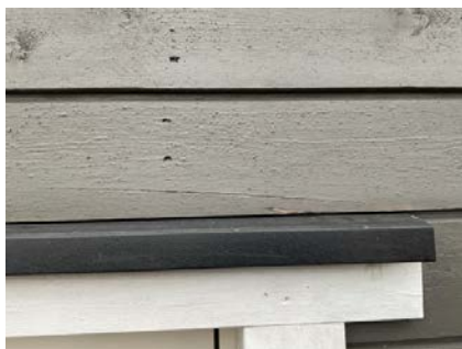
Sprekk i panel.
