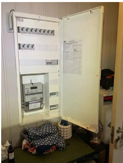
Sikringskap i gang.
