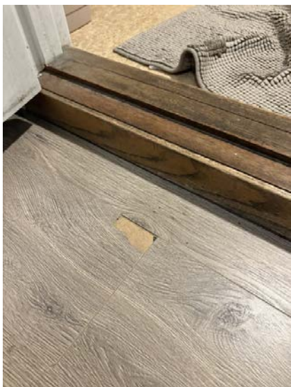
Skader i laminatgulv.
