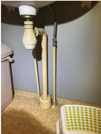
Vannrør på bad.
