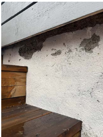
Avskalling på puss.
