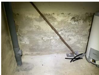
Salt/kalkutslag i kjeller.
