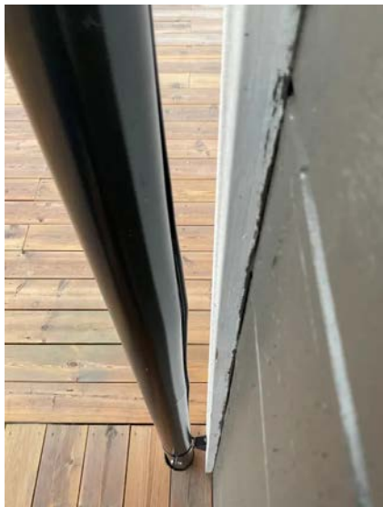
Frostspreg i nedløp.
