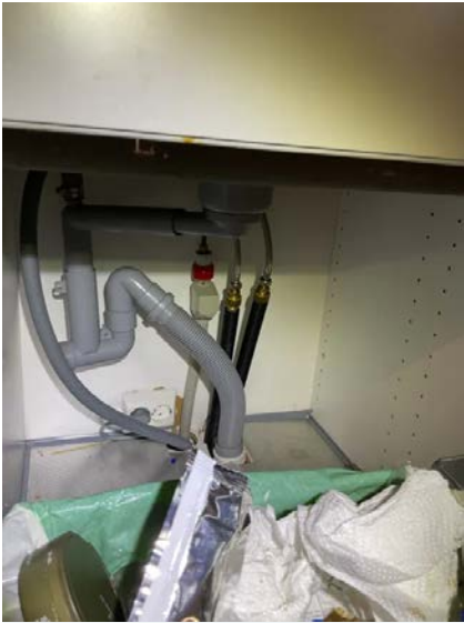
Vannrør på kjøkken.
