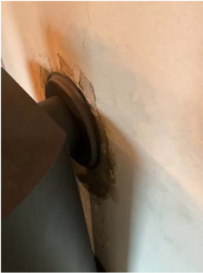
Avskalling i puss/maling rundt røykgjennomføring.
