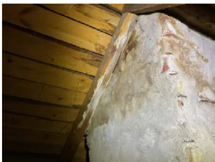
Fuktmerker rundt pipe.
