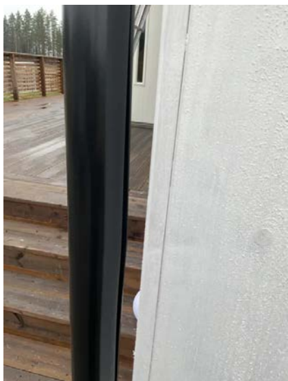
Frostspreg i nedløp.
