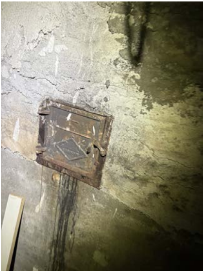
Rennemerker fra sotluke i kjeller.
