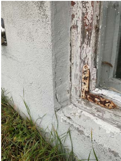
Sprekk i grunnmuren.
