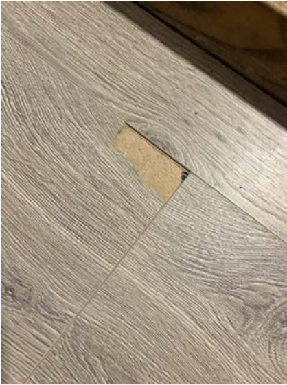
Skader i laminatgulv.
