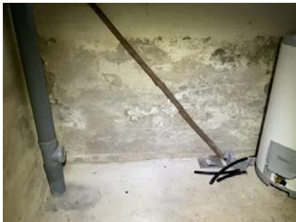
Salt/kalkutslag i kjeller.
