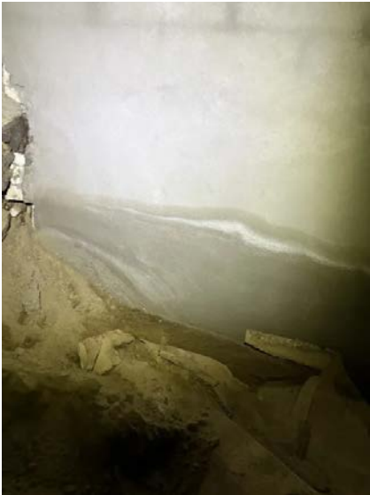
Fuktighet i jordgulv og saltutslag.
