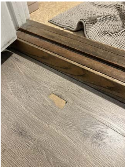
Skader i laminatgulv.
