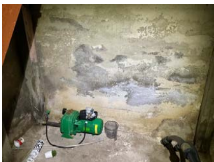
Salt/kalkutslag i kjeller.
