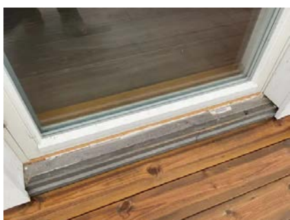
Manglende beslag til terrassedør.
