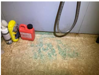
Missfarging på plater og belegg.
