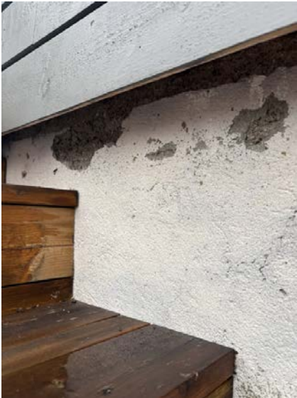
Avskalling på puss.
