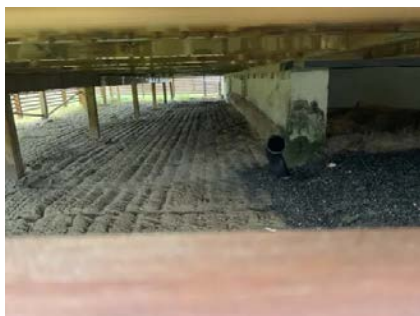
Taknedløp er avsluttet over terreng.
