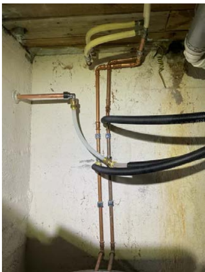
Vannrør i kjeller.
