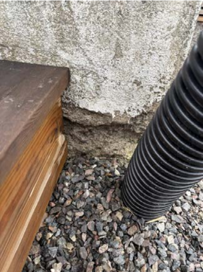
Avskalling på puss.
