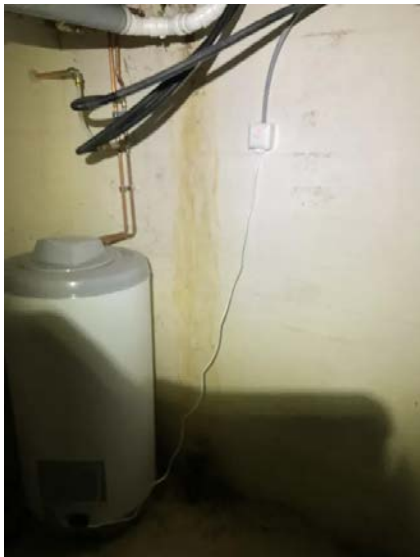
Dårlig innfesting av kabler.
