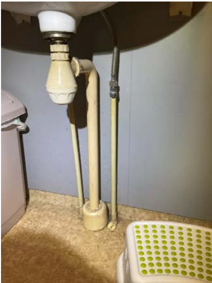
Vannrør på bad.
