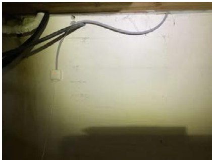
Dårlig innfesting av kabler.
