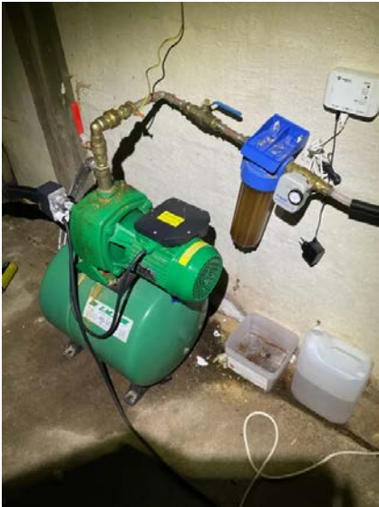
Stoppekran og vannpumpe.
