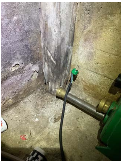
Råteskader i treverk.
