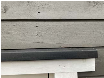
Sprekk i panel.
