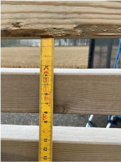
Avstand mellom spiler i rekkverk.
