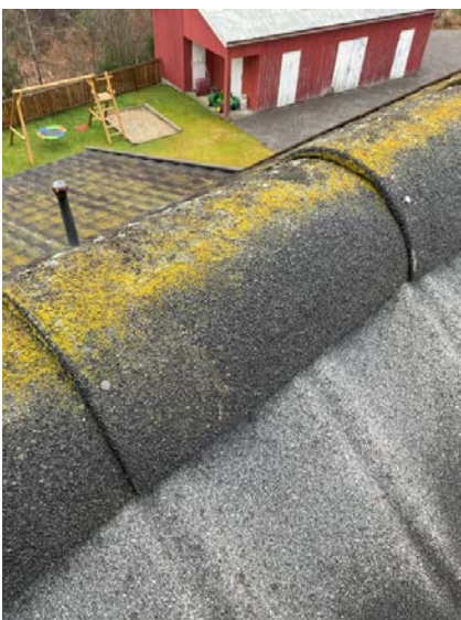
Løs innfesting av taktekkning.
