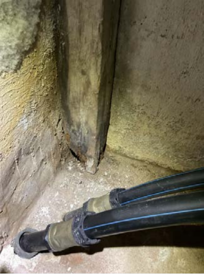
Råteskader i treverk.
