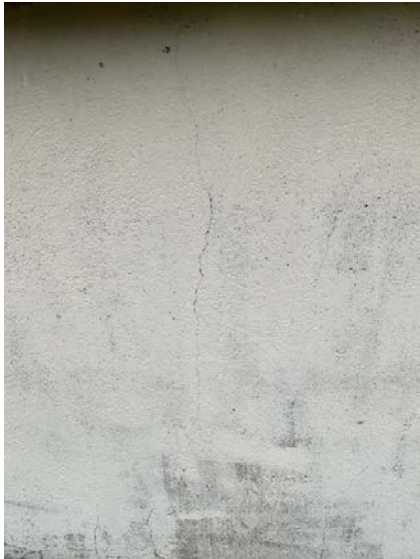
Sprekker i grunnmuren.
