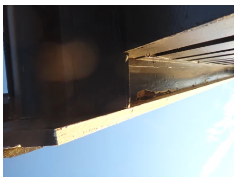
Avskalling/flassing oppunder gesims.
