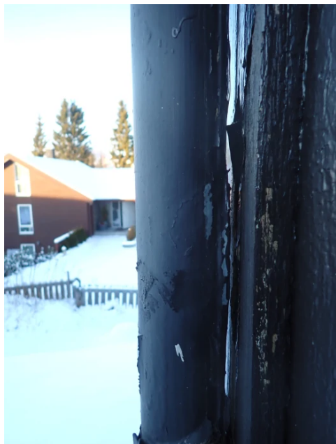
Frostspreg i nedløpsrør.
