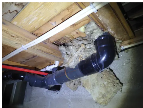
Symptom på skader i konstruksjon under dusjsone.
