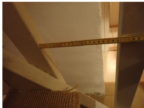
Åpninger i rekkverk > 10 cm.
