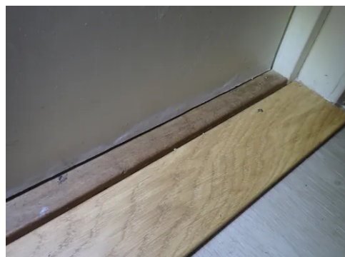
Fuktskade i bunn av dørblad.
