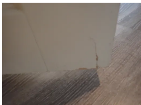
Liten skade/sprekk i bunn av dør til badet.
