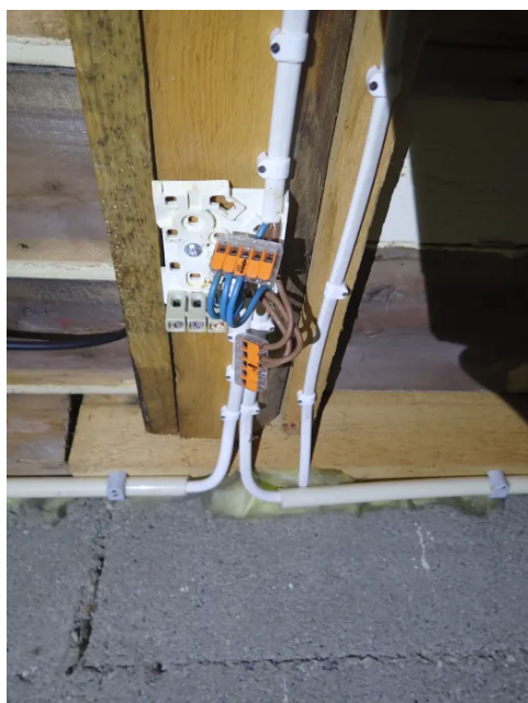
Manglende lokk på koblingsboks i kryprom.
