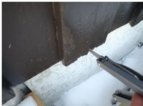
Symptom på råde i bunn av kledningsbord.
