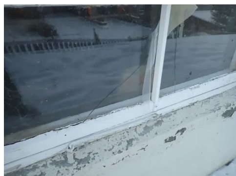
Sprekk i vindusglass, samt slitte karmen og kittfalsen.
