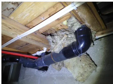
Fuktskjolder i området under dusjsonen fra badet.
