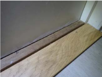
Fuktskade i bunn av dørblad.
