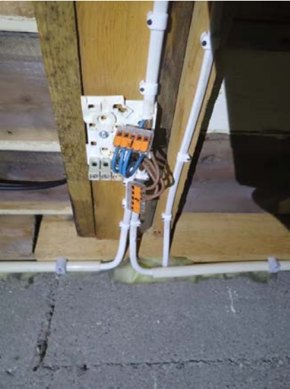
Manglende lokk på koblingsboks i kryprom.
