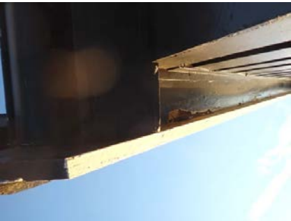
Avskalling/flassing oppunder gesims.
