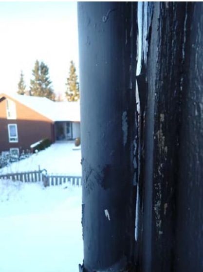
Frostspreg i nedløpsrør.
