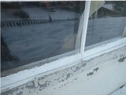
Sprekk i vindusglass, samt slitte karmner og kittfalsler.
