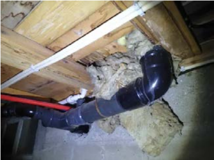
Symptom på skader i konstruksjon under dusjsone.
