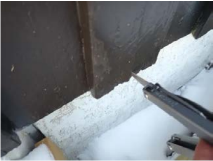
Symptom på råte i bunn av kledningsbord.
