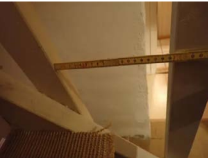
Åpninger i rekkverk > 10 cm.
