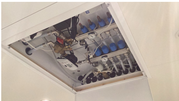
Fordelerskap i himling på bad
