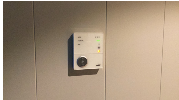
Styringspanel på vegg i gang.
