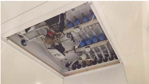
Fordelerskap i himling på bad
