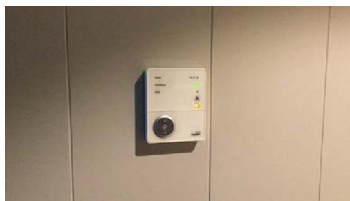
Styringspanel på vegg i gang.
