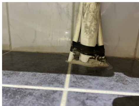
Ikke registrert mansjett i rørgjennomføring/sluk
