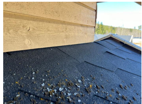
Manglende bruk av beslag
