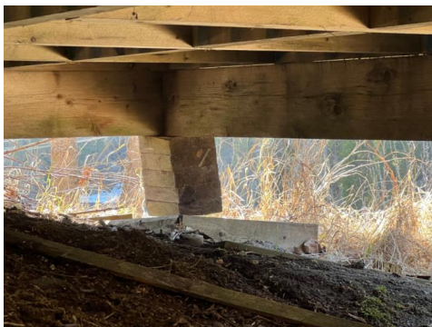
Enkel og ufagmessig fundamenter
