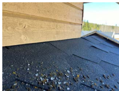
Manglende bruk av beslag
