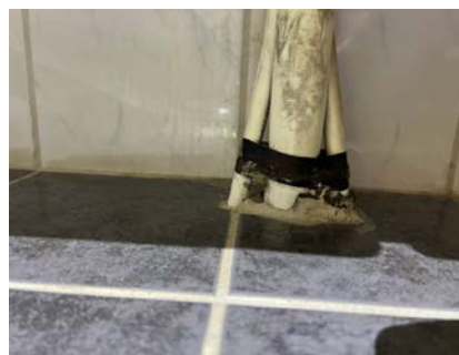
Ikke registrert mansjett i rørgjennomføring/sluk
