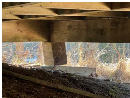
Enkel og ufagmessig fundamenter
