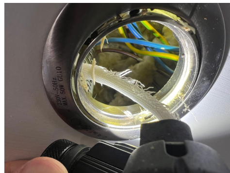
Manglende bruk av spottkasse
