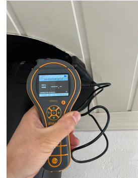
Fuktskjolder ved pipestamme, ved fuktmåletaking var det ikke fuktutslag
