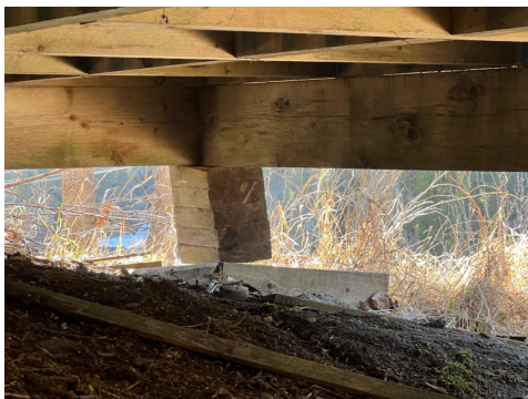
Enkel og ufagmessig fundamenter
