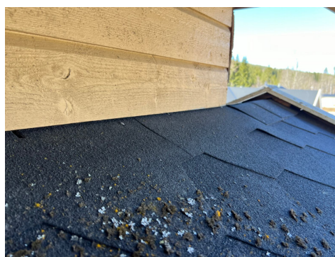
Manglende bruk av beslag
