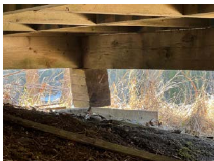
Enkel og ufagmessig fundamenter
