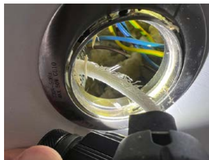
Manglende bruk av spottkasse
