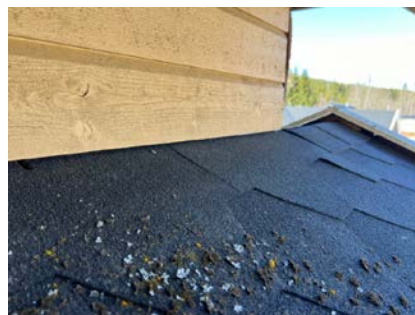
Manglende bruk av beslag
