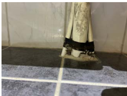
Ikke registrert mansjett i rørgjennomføring/sluk
