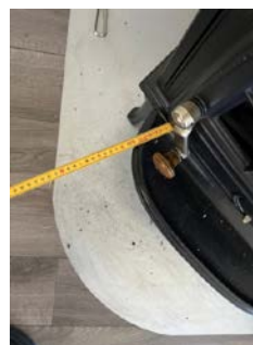
For kort plate på gulv foran ovn ihenhold til krav om avstand til brennbart materiale
