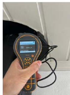
Fuktskjolder ved pipestamme, ved fuktmåletaking var det ikke fuktutslag
