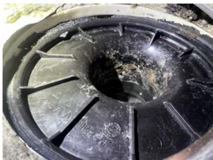
Ingen synlig membran fra sluk under klemring, påført med silikon i overgang, ikke egnet
