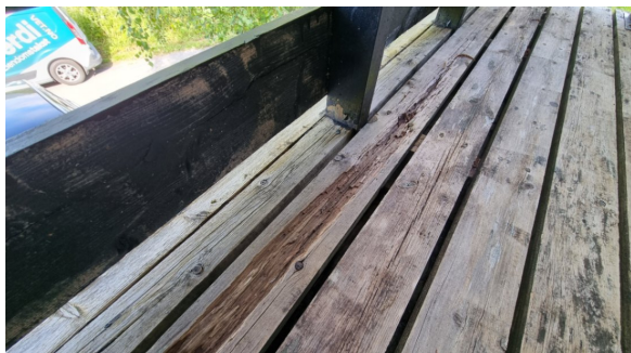
Svekkelser i balkong utenfor soverommet.
