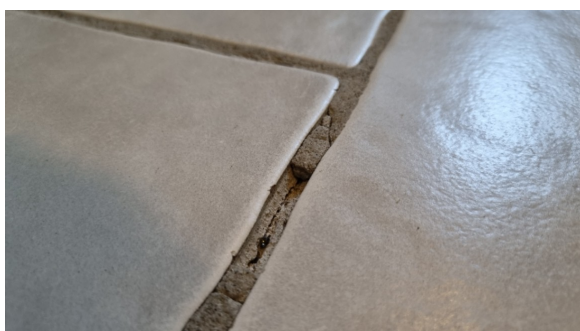
Stedvis manglende fuger og bom under fliser i trappehall.
