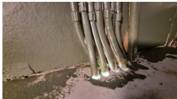
Utsett kabelinnføring i el-skapet.
