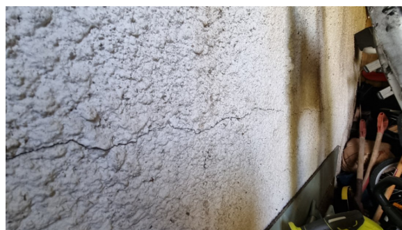
Riss/sprekker i utvendige grunnmur.
