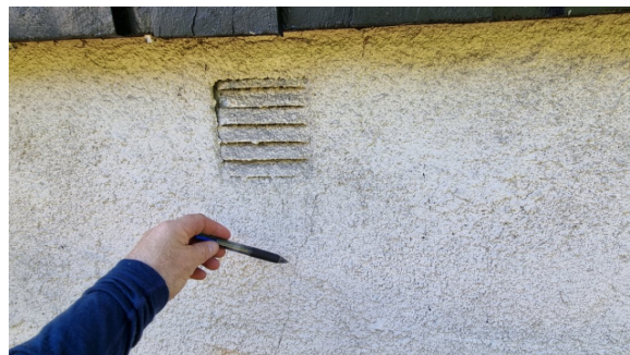
Riss/sprekker i utvendige grunnmur.
