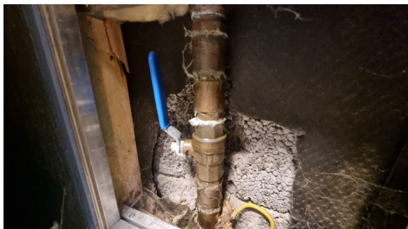
Kontroll av innvendig hovedstoppekran.
