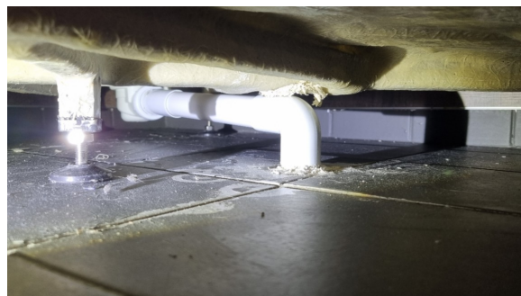
Avløp fra dusjkabinettet blir ledet direkte til avløpsrør.
