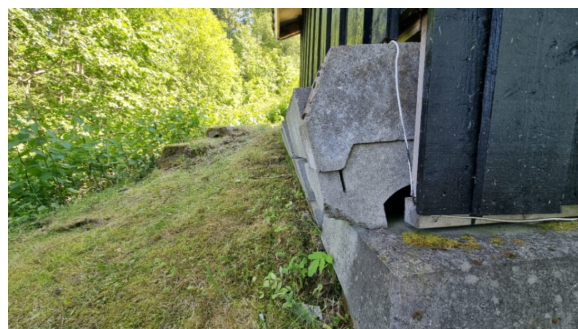
Betydelige skjevheter i grunnmur.
