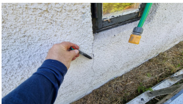
Riss/sprekker i utvendige grunnmur.
