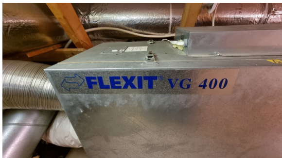
Ventilasjonsaggregat på kaldloftet.
