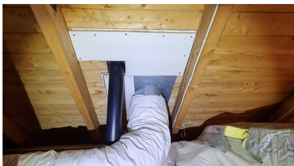
Luftingen av kloakken er ledet ut over tak.
