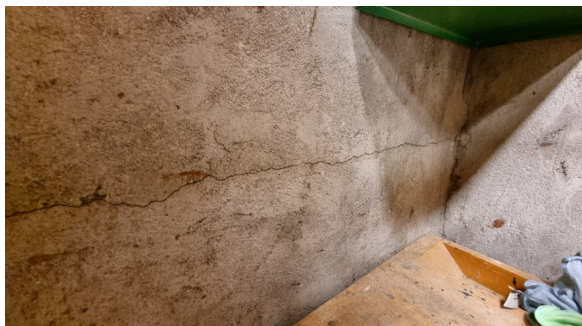
Synlig innvendig riss/sprekk i rommet bak garasjerommet.
