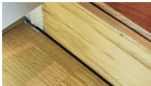
Glippe mellom parkett på gulv og dørterskel til bad/wc i hovedetasjen.
