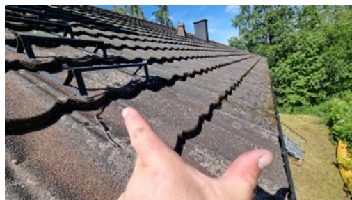
Noe stor avstand mellom takfot og første trinn i stigen på taket.
