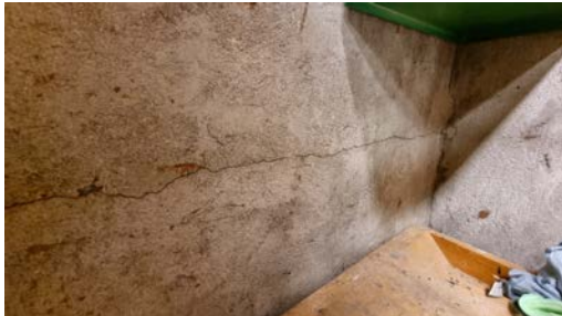
Synlig innvendig riss/sprekk i rommet bak garasjerommet.
