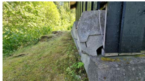
Betydelige skjevheter i grunnmur.
