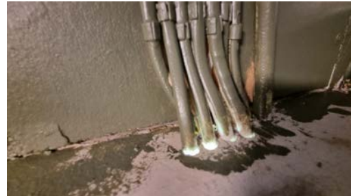
Utettet kabelinnføring i el-skapet.
