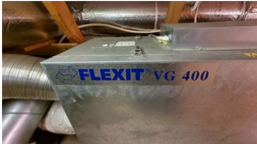
Ventilasjonsaggregat på kaldloftet.
