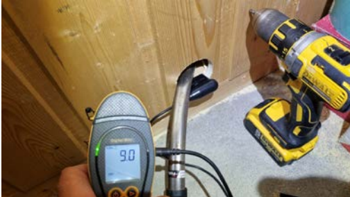
Hulltaking utført i yttervegg under trappen.
