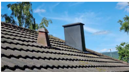
Luftehatter på taket.
