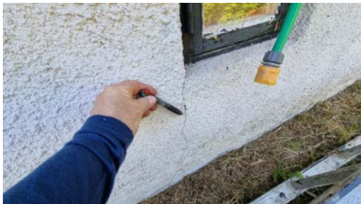
Riss/sprekker i utvendige grunnmurer.
