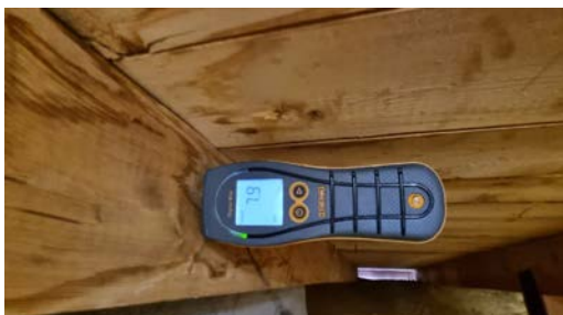
Noe fuktmerker i takkonstruksjonen ved pipen. Det ble fuktmålt her ved befaring, ingen unormale fuktverdier ble registrert.
