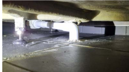
Avløp fra dusjkabinettet blir ledet direkte til avløpsrør.
