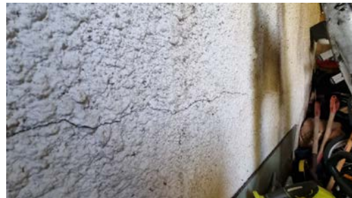
Riss/sprekker i utvendige grunnmurer.
