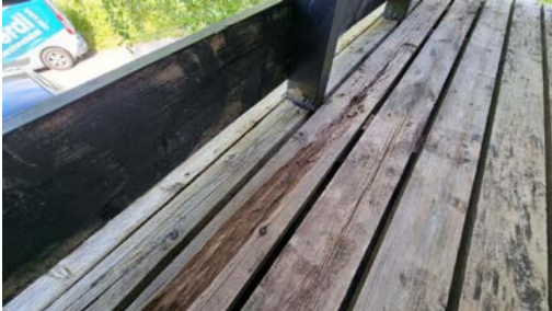
Svekkelser i balkong utenfor soverommet.
