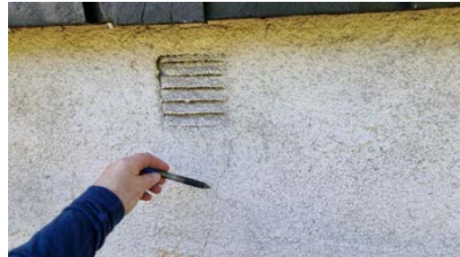
Riss/sprekker i utvendige grunnmurer.
