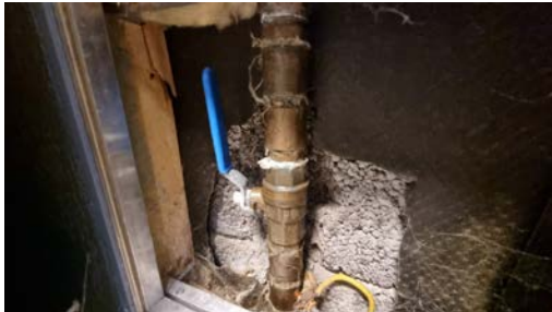
Kontroll av innvendig hovedstoppekran.
