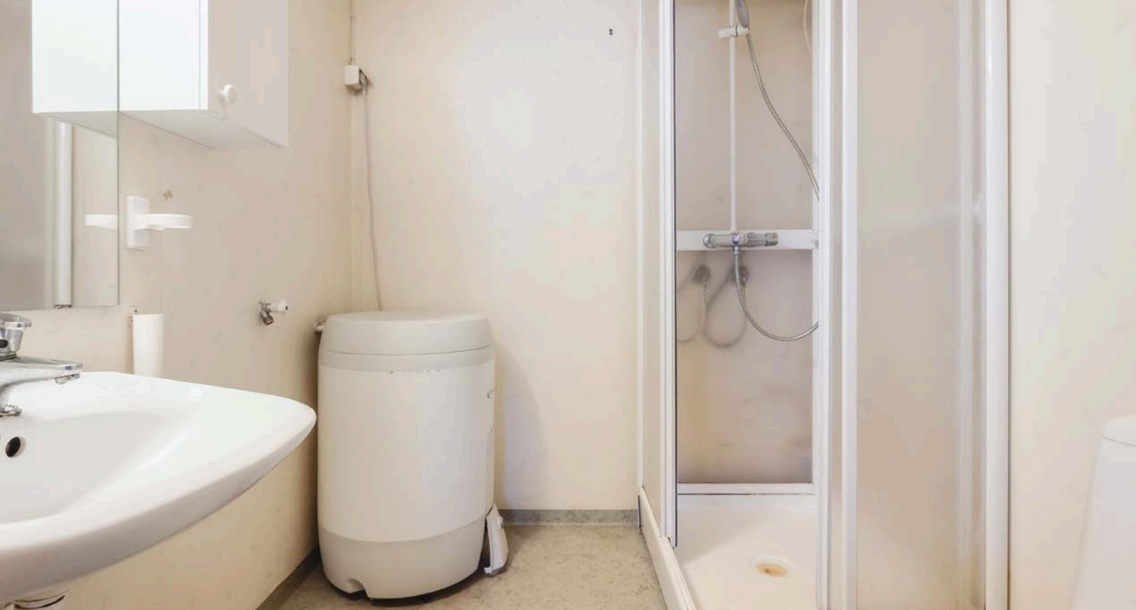
Bad med belegg på gulvet og våtromstapet på veggene. Dusjkabinett og opplegg for vaskemaskin. Badet har behov for oppgraderinger for å tilfredsstille dagens krav til standard.
