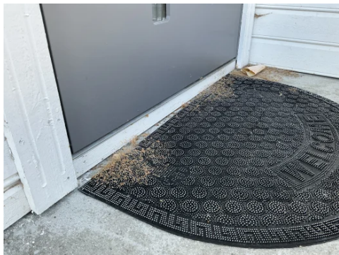
Beslag ved terskel til inngangs-dør er ikke montert.
