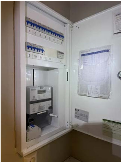
Sikringsskap i kjeller.
