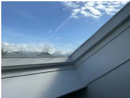
Punkttert takvindu på loft.
