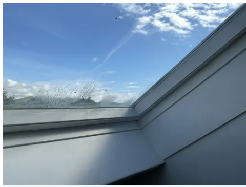
Punkttert takvindu på loft.
