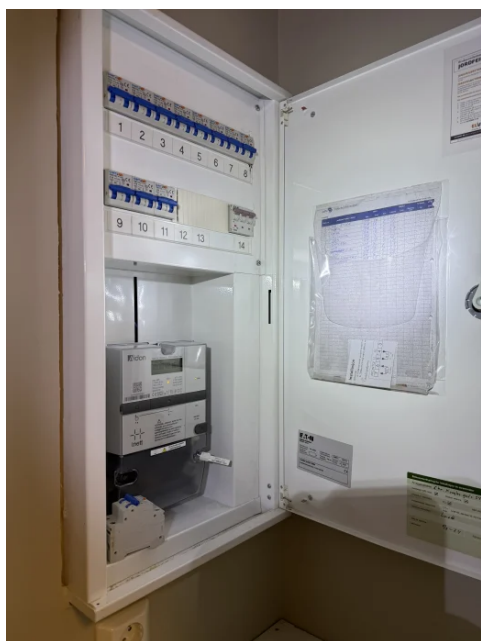
Sikringsskap i kjeller.
