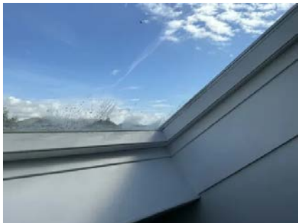
Punkttert takvindu på loft.
