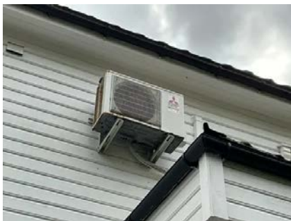
Alder på varmepumpe er ikke kontrollert på grunn av tilgang.
