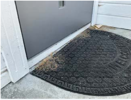
Beslag ved terskel til inngangs-dør er ikke montert.
