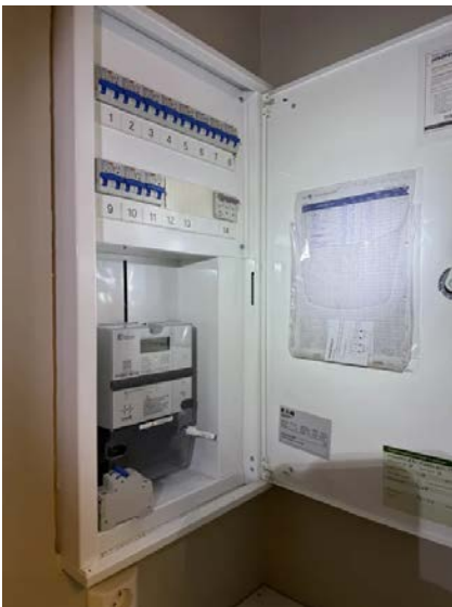
Sikringsskap i kjeller.
