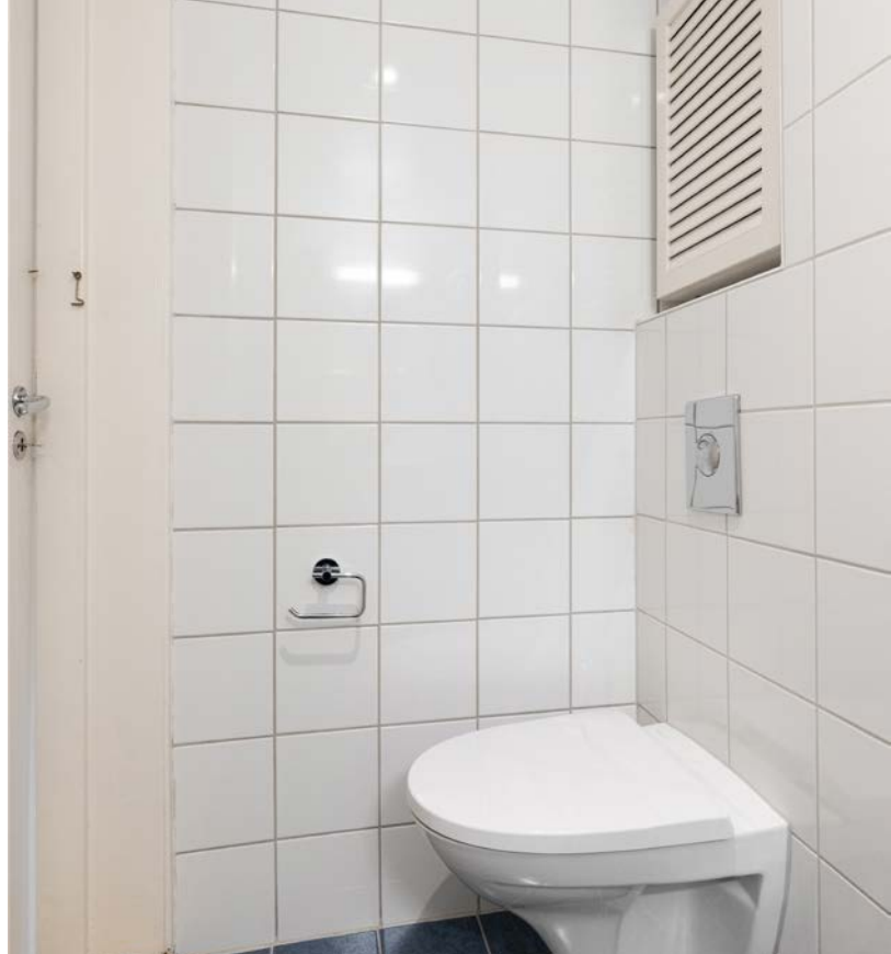
Det er ny veggmontert toalett fra 2013 i hvit porselen med innebygd susterne
