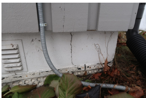
Bilde viser sprekkdannelse i grunnmur
