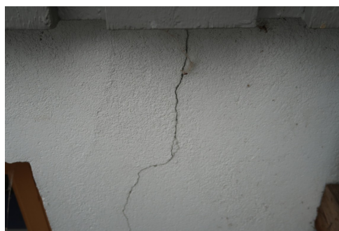
Bilde viser sprekkdannelse i grunnmur
