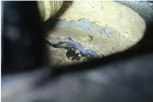
Bilde viser synlig slukmansjett under klemring i sluk
