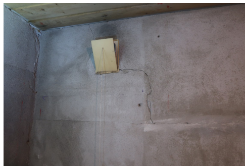
Bilde viser sprekkdannelse i grunnmur
