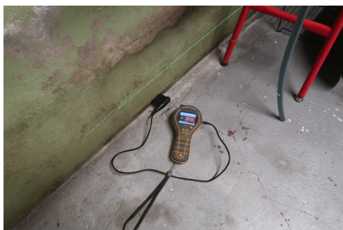
Fukt i delevegg mellom vaskerom og innredet rom
