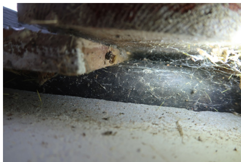
Bilde viser manglende musesperre bak ytterkledning
