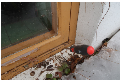
Råteskade i vindu mot sør
