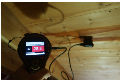
Påvist lekkasje via yttertak
