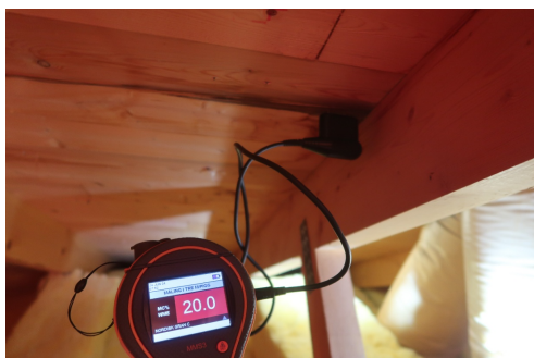
Påvist skadelig fukt ved gjennomføring i yttertak
