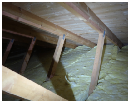
Bilde viser isolasjon som sperrer for ventilering/ lufting
