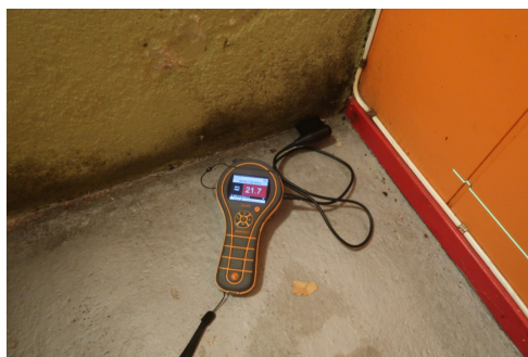
Fukt i delevegg mellom innredet rom og hobbyrom
