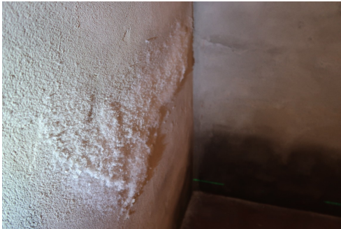
Bilde viser saltutslag og fuktskjolder
