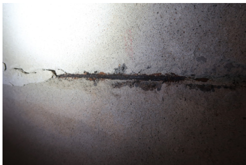
Bilde viser rustdannelse på armering
