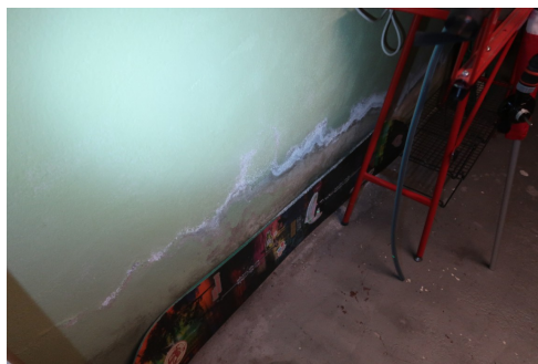
Fuktskjolder på vegg på vaskerom
