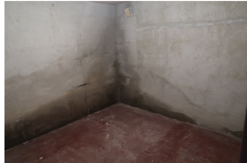
Bilde viser fuktskjolder på yttvegger under terreng
