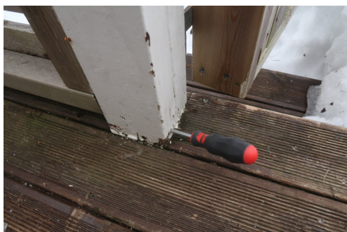
Råteskade i rekkverk på terrasse ved stue/ kjøkken
