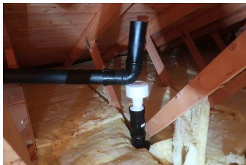
Bilde viser lufting av avløp via vakuumventil
