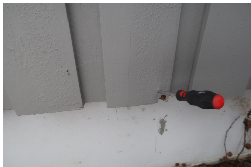
Bilde viser punktvis råteskade i ytterkledning. Bilde er tatt av fasade mot sør.
