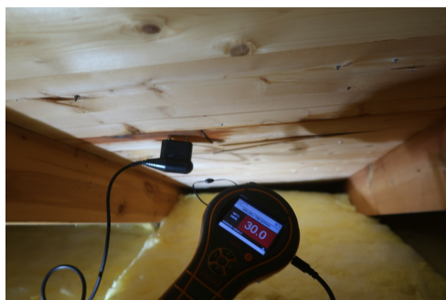
Påvist lekkasje via yttertak
