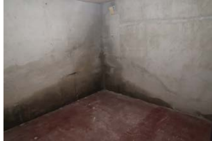
Bilde viser fuktskjolder på yttvegger under terreng
