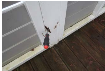
Råteskade i rekkverk på terrasse ved inngangsparti
