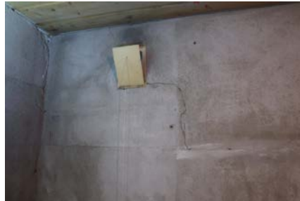
Bilde viser sprekkdannelser i grunnmur
