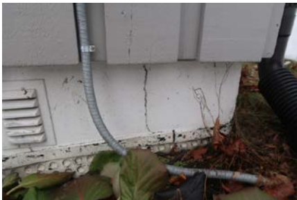
Bilde viser sprekkdannelser i grunnmur
