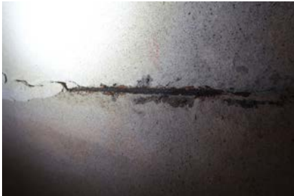
Bilde viser rustdannelse på armering
