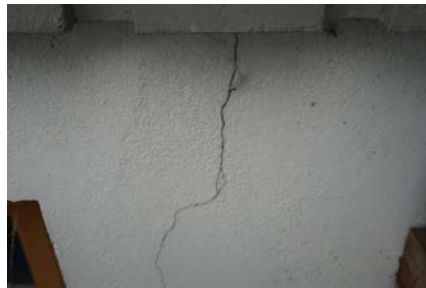
Bilde viser sprekkdannelser i grunnmur
