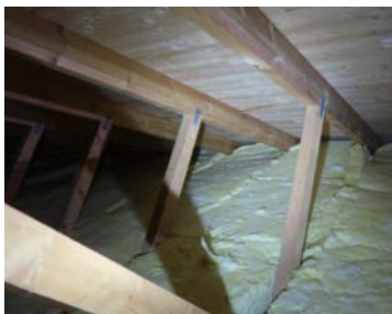
Bilde viser isolasjon som sperrer for ventilering/ lufting
