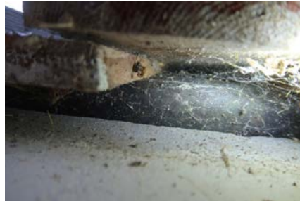
Bilde viser manglende musesperre bak ytterkledning
