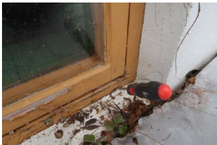
Råteskade i vindu mot sør
