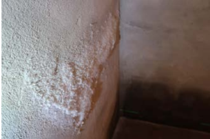
Bilde viser saltutslag og fuktskjolder
