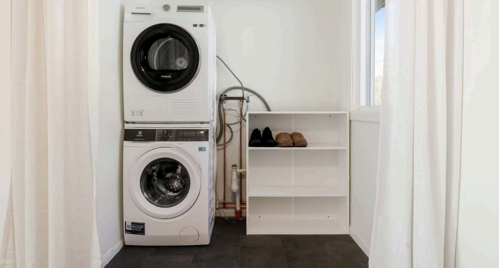
Vaskerommet har panel på vegger og pusset murverk, med grovstøpt betonggulv uten fall mot sluk. Rommet mangler membran og tettesjikt, noe som kan medføre behov for oppgradering.
