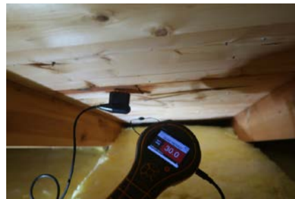
Påvist lekkasje via yttertaket
