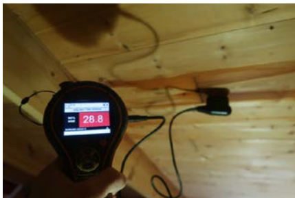
Påvist lekkasje via yttertaket
