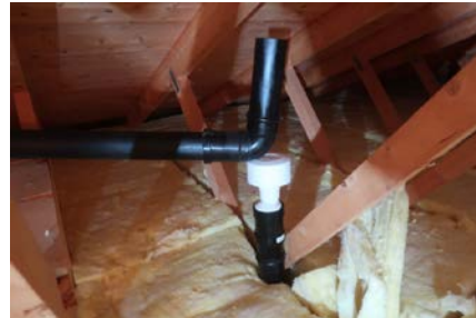
Bilde viser lufting av avløp via vakuumentil
