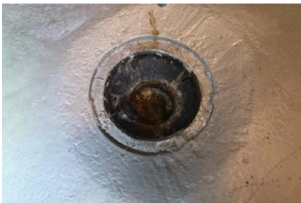
Bilde viser sluk på vaskerom uten membran/ vanntett sjikt
