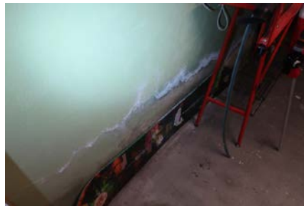
Fuktskjolder på vegg på vaskerom
