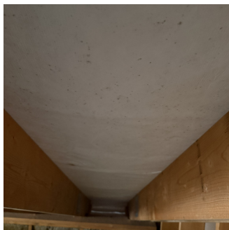
Tegn til svertesopp på undertaksduk
