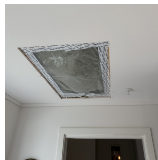
Åpningen er ikke tilrettelagt for inspeksjon.
