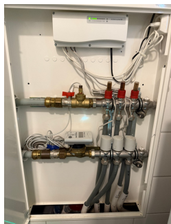
Vannskap for vannbåren varme.
