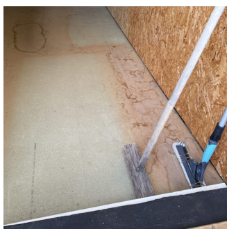
Synlige fuktmerker på gulvet.
