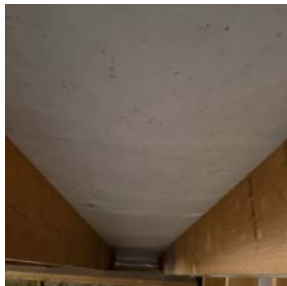
Tegn til svertesopp på undertaksduk
