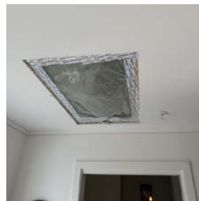
Åpningen er ikke tilrettelagt for inspeksjon.
