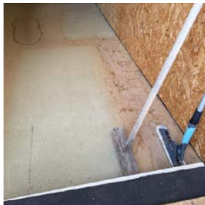
Synlige fuktmerker på gulvet.
