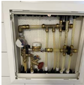
Vannskap plassert i vaskerom
