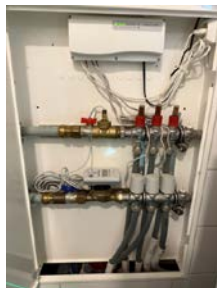
Vannskap for vannbåren varme.
