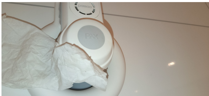
Funksjonstest av avtrekk.
