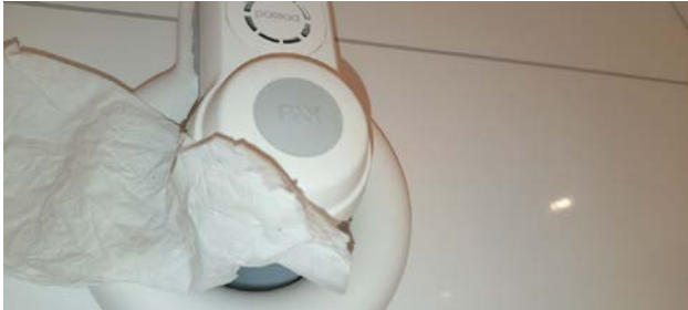
Funksjonstest av avtrekk.
