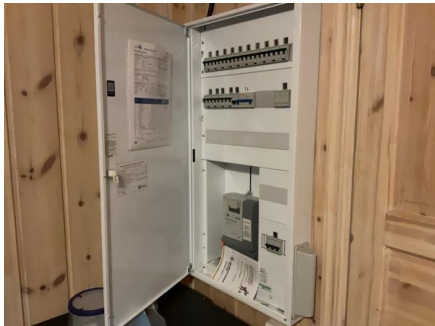
Sikringskap plassert i gang.
