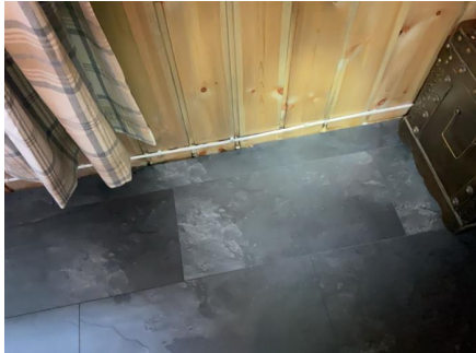
Gjenstående arbeid. Fotlist ikke montert.
