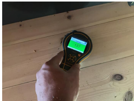
Med enkle fuktsøk bel det ikke registrert unormale verdier.
