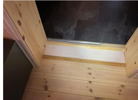
Gjenstående arbeid. Terskel ikke montert.
