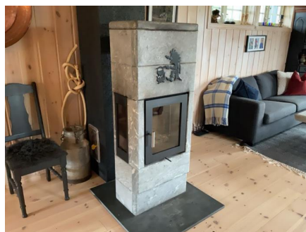
Ildsted plassert på stue.
