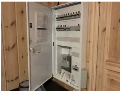
Sikringsskap plassert i gang.
