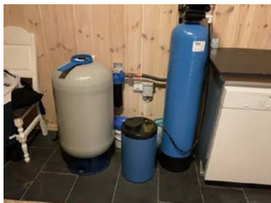
Stoppekran, trykktank og renseanlegg plassert i gang.
