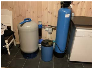
Stoppekran, trykktank og renseanlegg plassert i gang.
