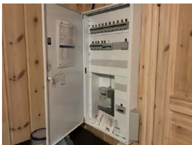
Sikringsskap plassert i gang.
