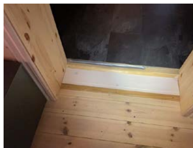
Gjenstående arbeid. Terskel ikke montert.
