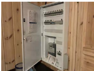
Sikringsskap plassert i gang.
