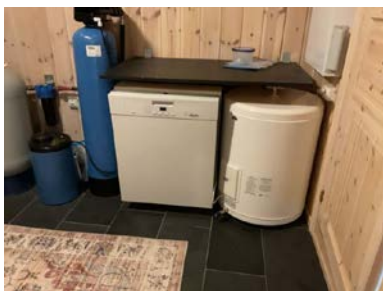
Oppvaskmaskin plassert i gang.
