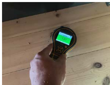
Med enkle fuktsøk bel det ikke registrert unormale verdier.
