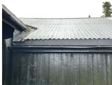
Takrenner har blitt bøyd, sannsynligvis som følge av snøras.
