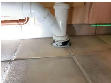
Utettheter i membran rundt rørgjennomføringer.
