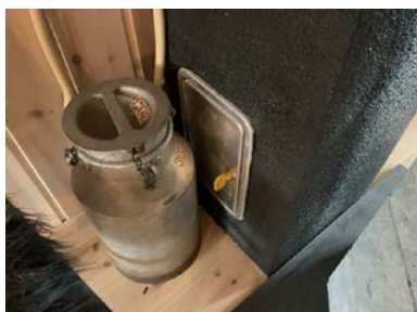
Sotluke plassert på stue.
