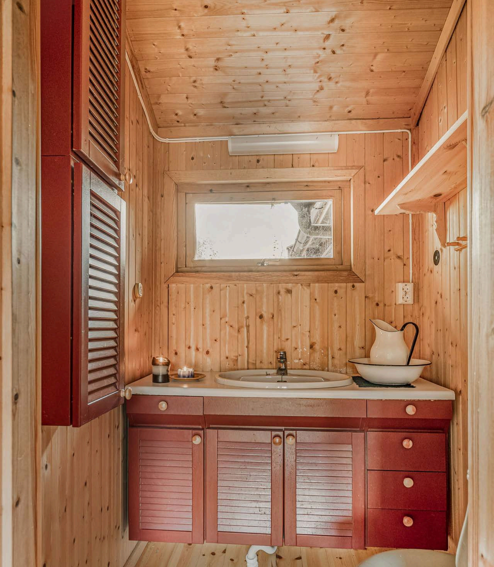
Sanitærrom med servant og skap/skuffer. Det er ikke innlagt vann.
