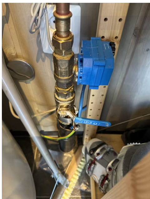
Hovedvannledning med stoppekran.
