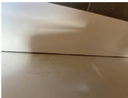
Fuktmerker på innredning.
