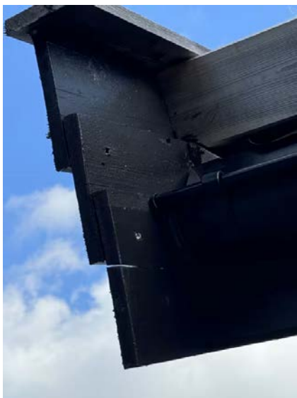
Sprekk i vindskie.
