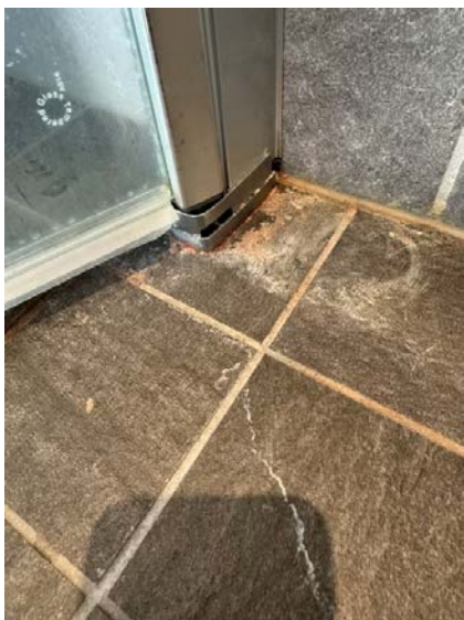
Noe kalkdannelse og bruksmerker.
