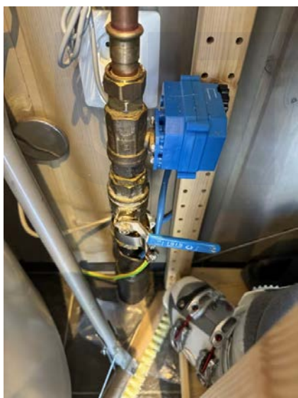
Hovedvannledning med stoppekran.
