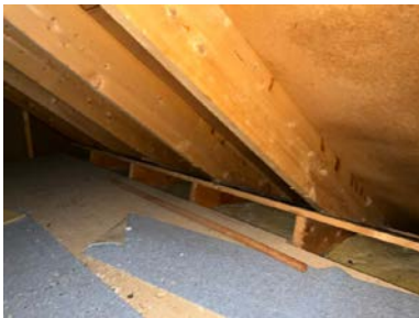
Spor etter mus og flere eldre fuktmerker.
