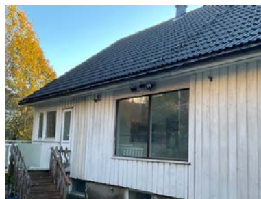
Stigetrinn er montert men ikke i hht dagens krav.
