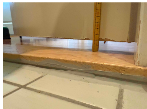
Bildet viser dørbladet til badet med noe fukt og svelleskade.
