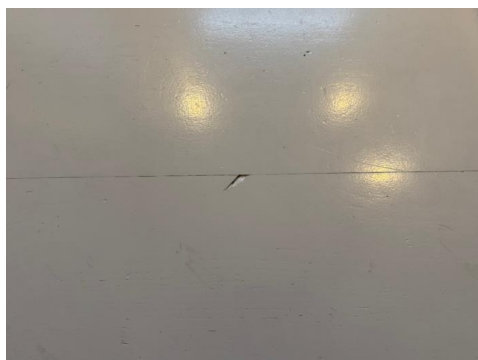
Hakk i gulv på kjøkken.
