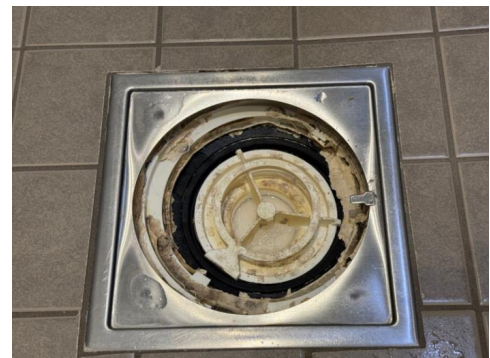
Plastsluk i dusjsone.
