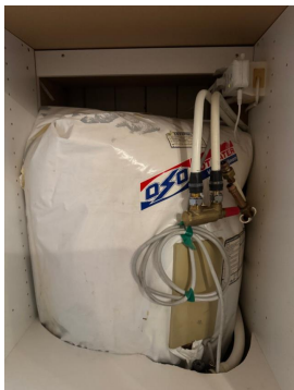
Varmtvannstank i kjøkkenskap.
