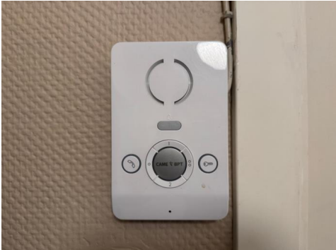
Dørtelefon i entre/gang.
