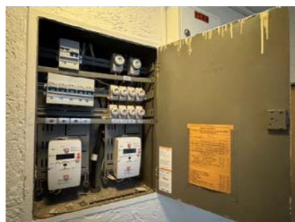
Sikringsskap i fellesarealer. Sikringer som tilhører leiligheten, er på venstre del i skapet.
