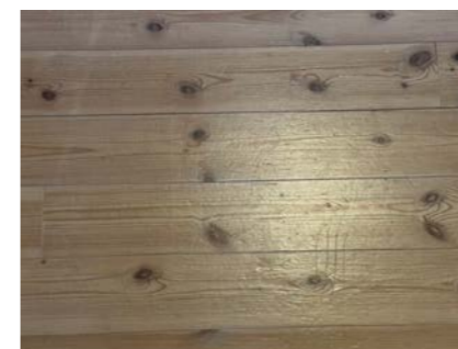
Slitasje/striper i tregulv på det ene soverommet.
