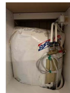
Varmtvannstank i kjøkkenskap.
