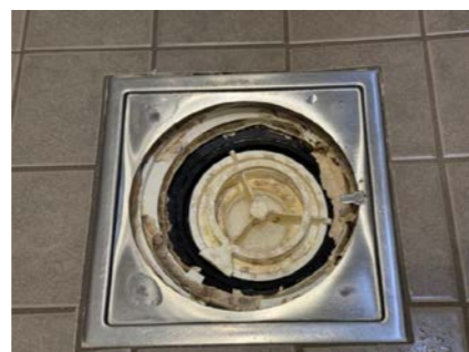
Plastsluk i dusjsone.
