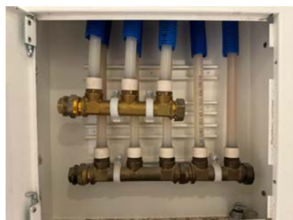
Ingen tegn til fukt/kondens i rør i rør skap. Rør i rør skap bør sjekkes for ev. lekkasje 2 ganger årlig.
