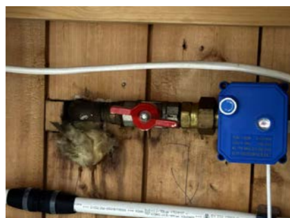
Stoppekran i kjøkkenskap.
