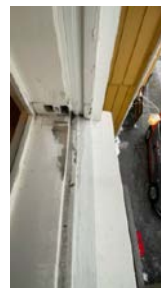
2 etg utleie trege, slitt uten dryppkant. Eldre vinduer syd
