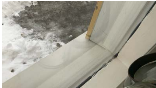
Manglende dryppkant vindu stue. Fuktskader foring vindu stue.
