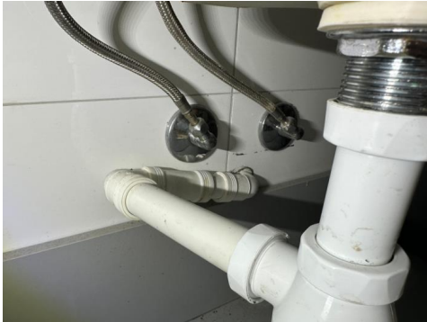
Røropplegg i servantskap
