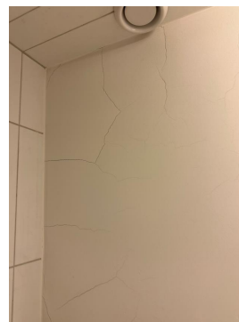
Setningssprekker i toalettrom himling
