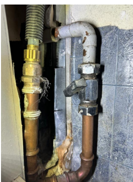
Hovedstoppekran bak luke til venstre for toalett
