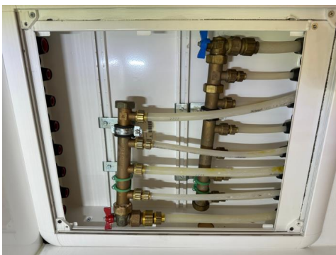
Umerket rørskap med 2 x stoppekraner
