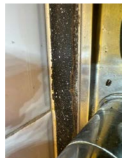
Svertesopp i fug bak kjøkkenkran
