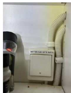
Avtrekk på bad styres fra bryter i ventilatorskap på kjøkken
