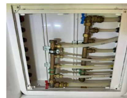
Umerket rørskap med 2 x stoppekraner
