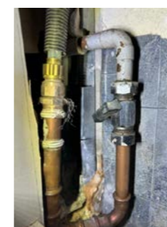
Hovedstoppekran bak luke til venstre for toalett
