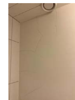
Setningssprekker i toalettrom himling
