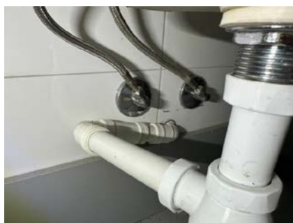
Røropplegg i servantskap
