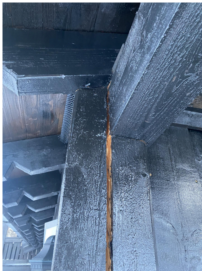
Staver med oppsprekking.
