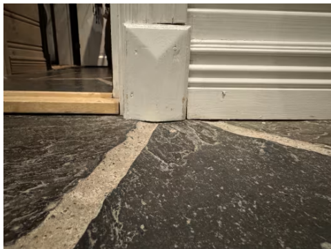
Vegger og dørterskel er uten vanntette oppkanter.
