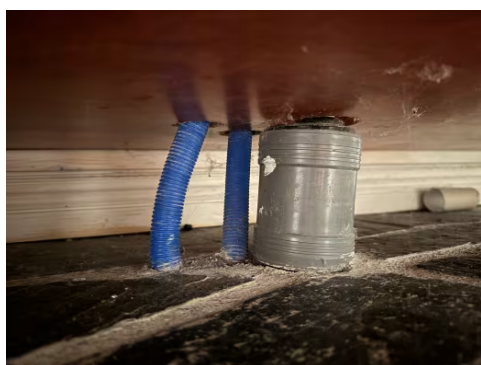
Rørføring uten påført tettesjikt.
