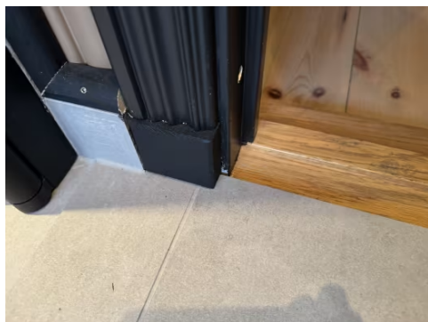
Ingen vanntett oppkant ved terskel eller på vegg ved dør.
