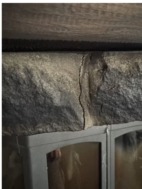
Mindre oppsprekking i forblending.
