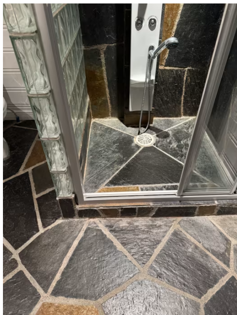
Sluket er avgrenset til inne i dusjsone.
