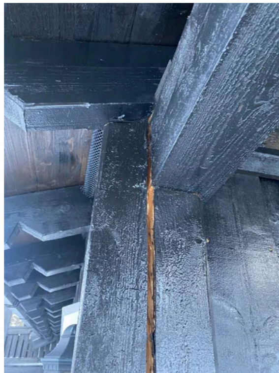
Staver med oppsprekking.
