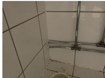
Uheldig rørgjennomføring i vegg i dusj.
