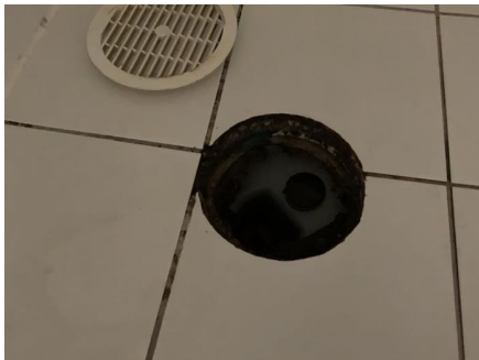
Slukløsning. Ukjent overgang til evt. gulvmembran.
