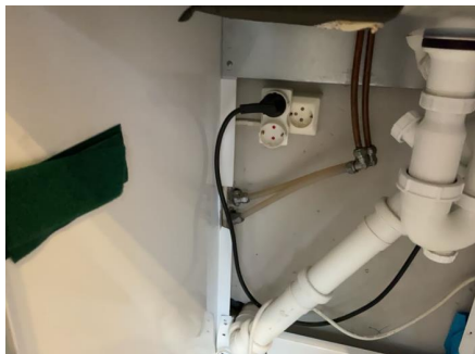
Rørøppligg i kjøkken.
