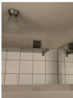
Det er avtrekksventil i "rommet".
