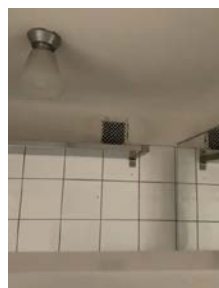
Det er avtrekksventil i "rommet".
