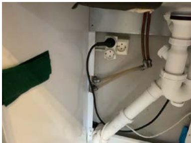
Røropplegg i kjøkken.
