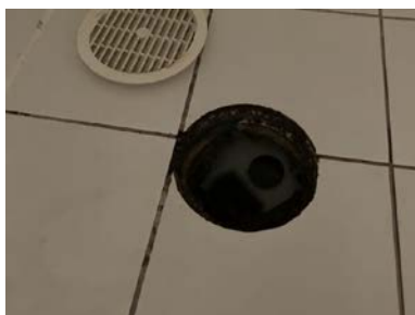
Slukløsning. Ukjent overgang til evt. gulvmembran.
