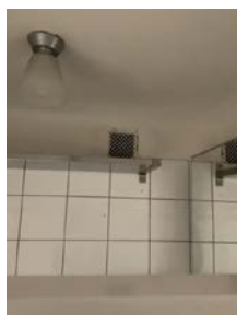
Det er avtrekksventil i "rommet".
