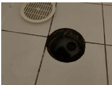
Slukløsning. Ukjent overgang til evt. gulvmembran.
