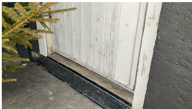
Dør i kjelleretasje med slitasje.
