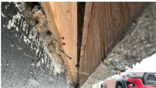
Manglende luftespalte i bunn av kledningen.
