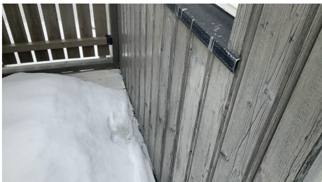
Værslitt og oppsprukket kledning.
