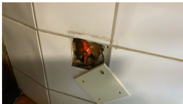
Stoppekran i vegg på bad i kjelleretasje.
